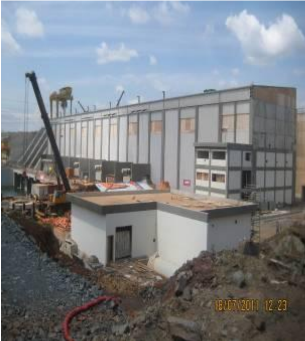
Bujagaali HPP: Power House
